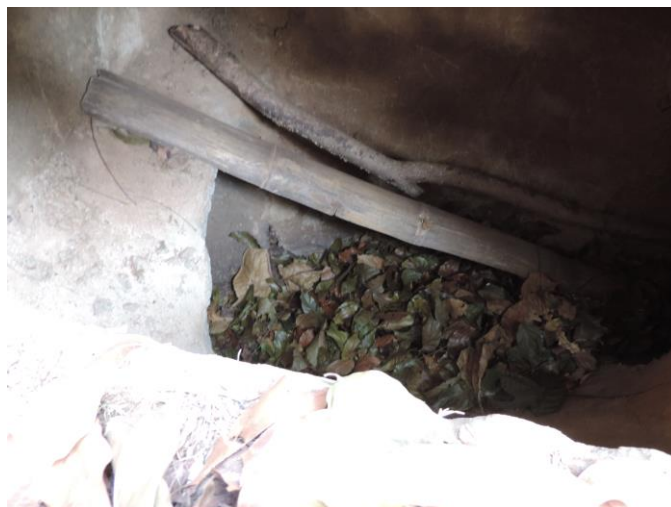
Figura 5.30: Canalização obstruída por lixo na microdrenagem do Jardim Goiás. Fonte: Acervo da autora (20/09/2014)
